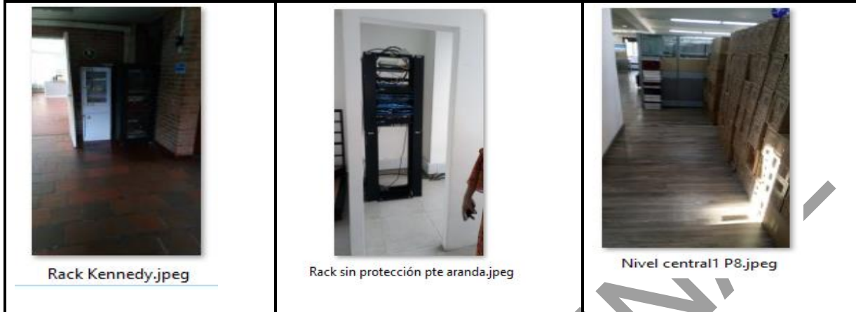
Figura 6 Activos sin protección física
